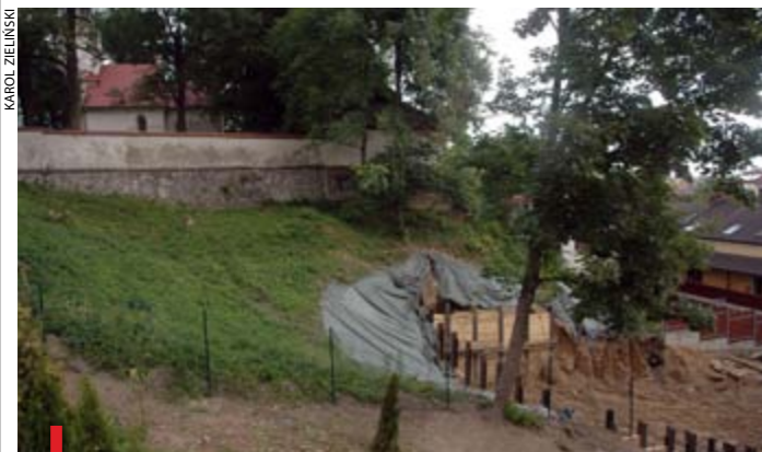
Na razie pojawiły się pęknięcia na murze wokół zabytkowego kościoła. Wielu krakowian pyta, czy świątyni nic grozi
