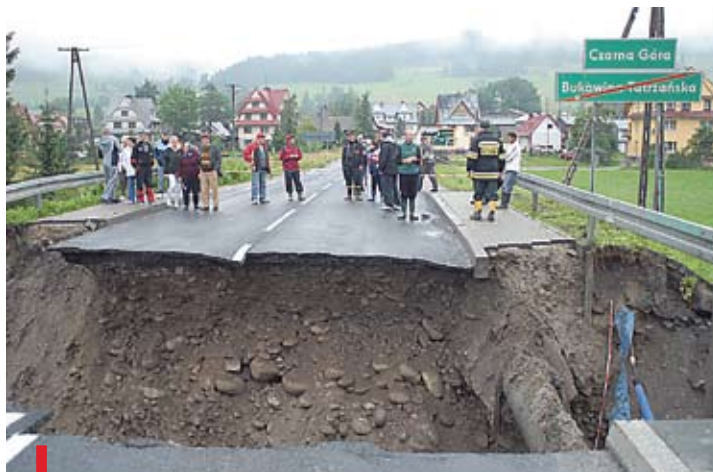
Uszkodzony most na drodze z Bukowiny Tatrzańskiej do Czarnej Góry i Jurgowa to jedno z największych zniszczeń ostatniej powodzi na Podhalu
